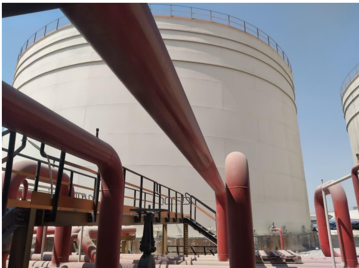
نمایی از مخازن آب آتش نشانی
