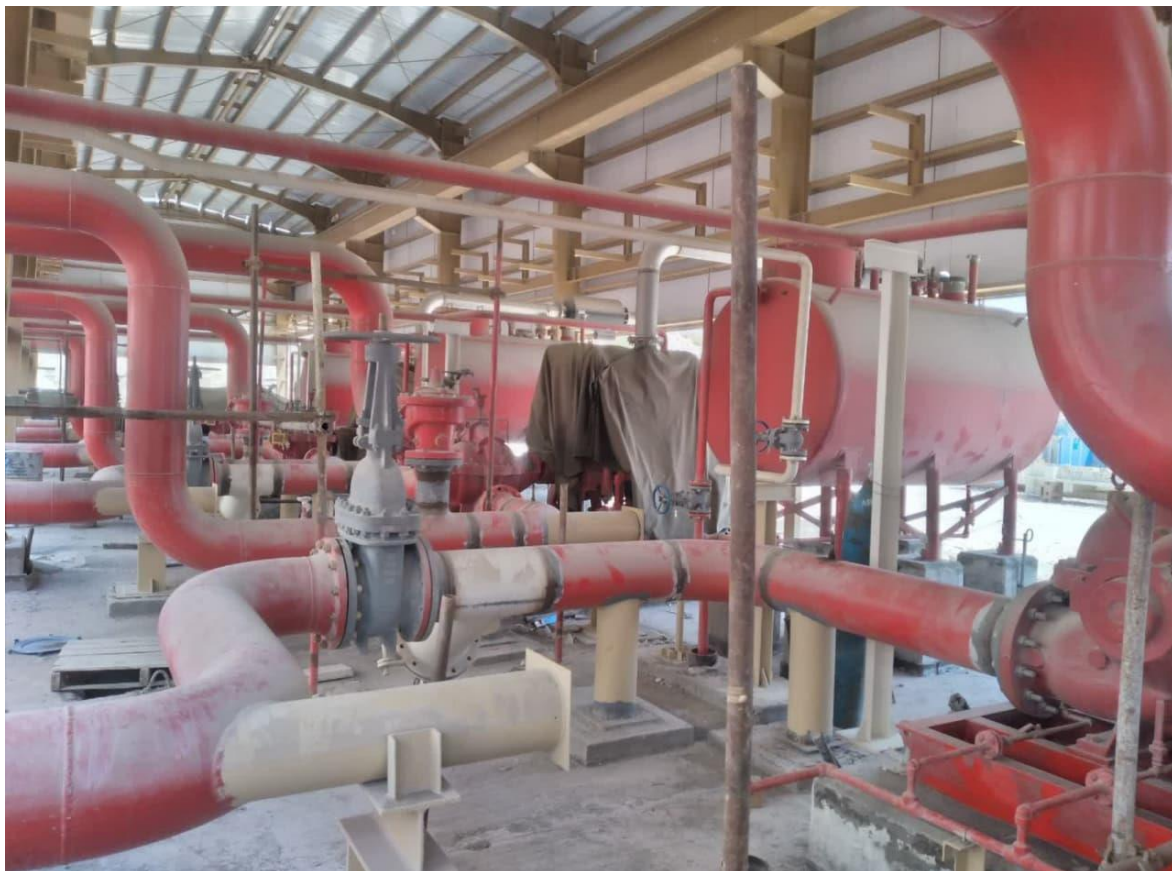
نمایی از تجهیزات واحد آب آتش نشانی (FWS)
