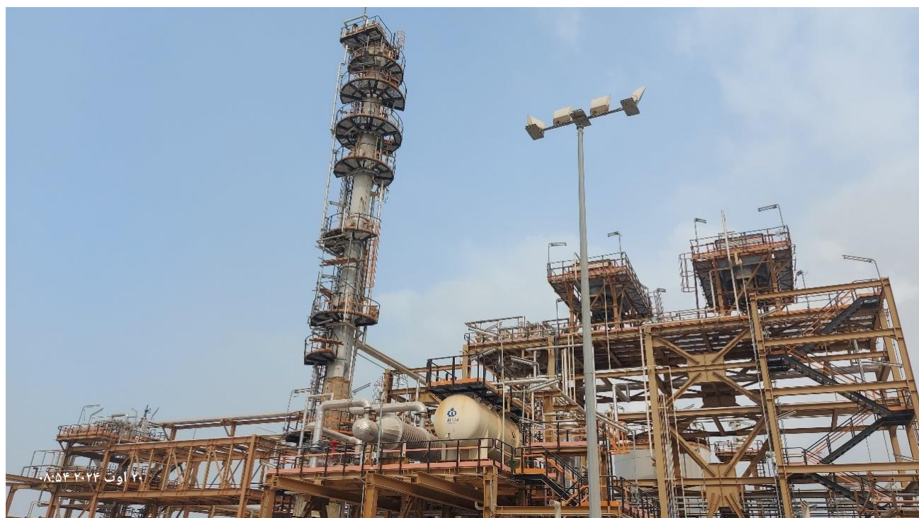
تصویر واحد تصفیه آب ترش (SWS)
