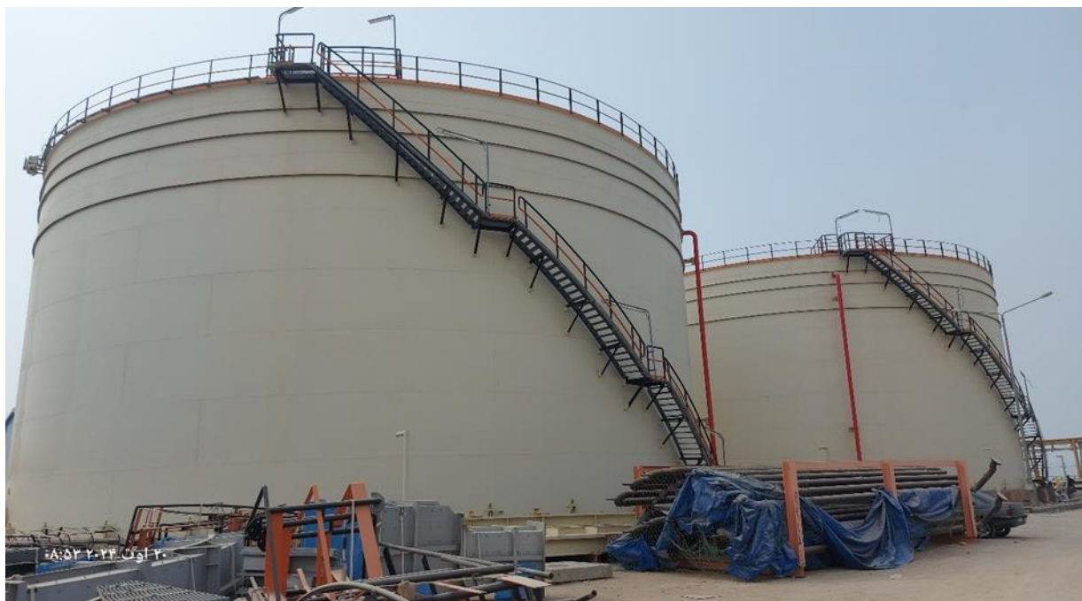
نمایی از مخازن آب آتش نشانی
