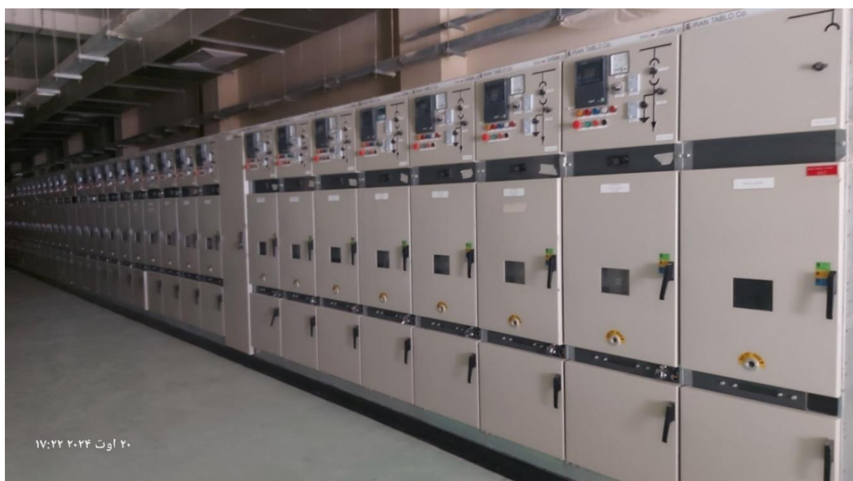
نمایی از اتاق تابلو (محل نصب تابلوهای برق)
