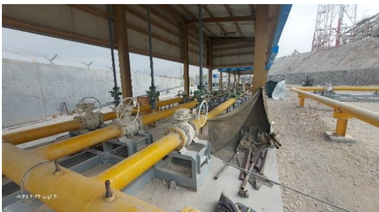
نمایی از تجهیزات نصب شده در واحد ایستگاه تقلیل فشار گاز
