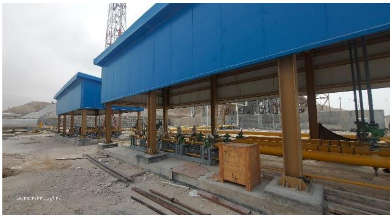
نمایی از سازه های واحد ایستگاه تقلیل فشار گاز
